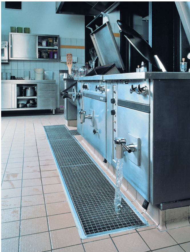
Canal realizado en acero inoxidable.
