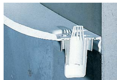
Evacuación con un sifón y filtro
