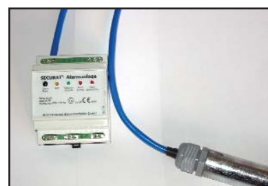
Sistema de Alarma SECURAT: La alarma avisa de la saturación o fuga del separador.
