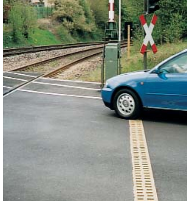
Monobloc RD 200 instalado transversalmente a la calzada en frente de un paso a nivel.
