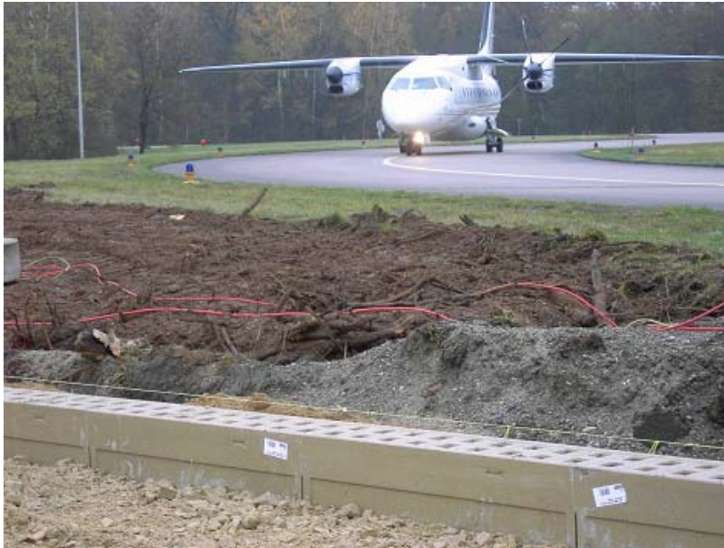
Proceso de instalación del la gama Monoblock en el aeropuerto de Manching (Alemania)
