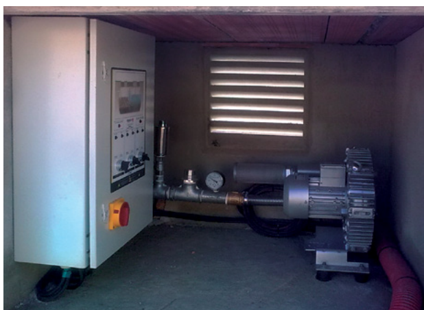
Cuadro eléctrico y compresor Quadro eléctrico e compressor
