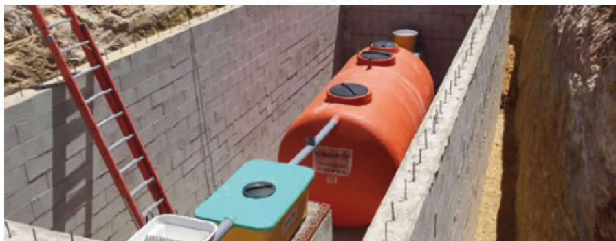
Instalación depuradora perfil hidráulico
