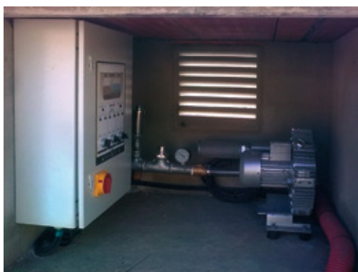
Cuadro eléctrico y compresor
